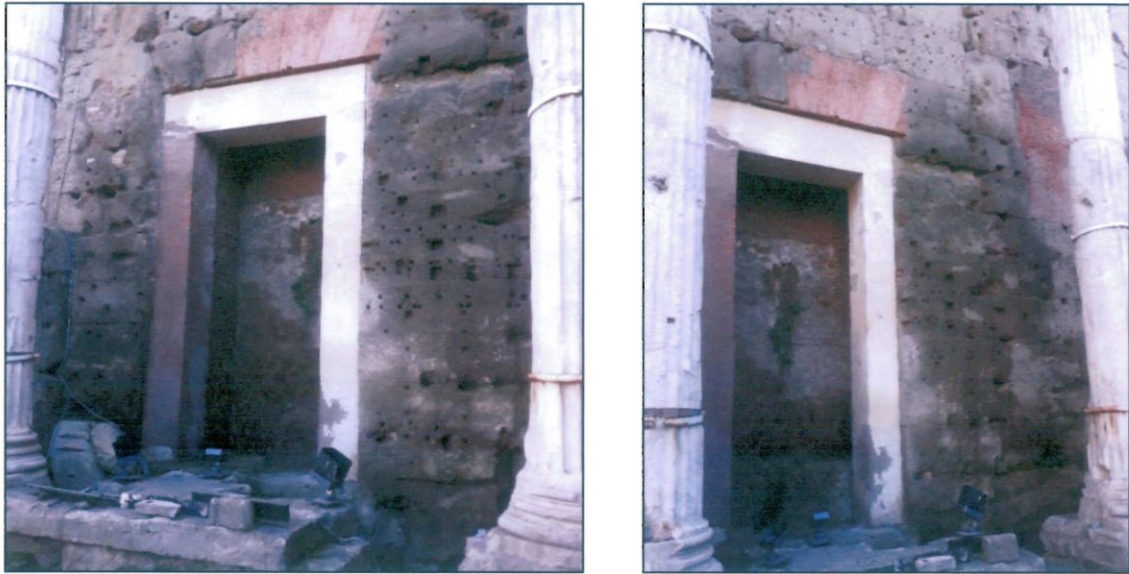
Figg. 23 e 24 – Foro di Nerva- Muro a blocchi di peperino con evidenti tracce di umidità- (Archivio Fori Imperiali/Mercati di Traiano).
